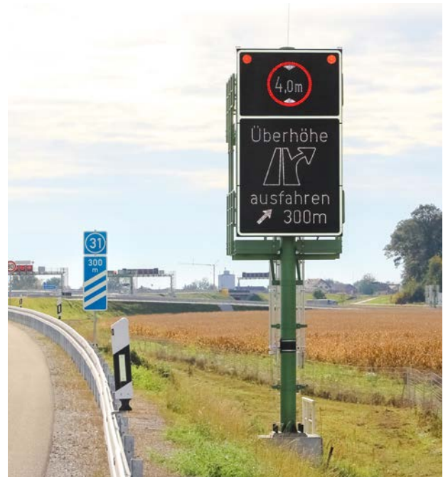
Mit Hilfe der LED-Anzeigen werden überhohe Fahrzeuge sofort ausgeleitet.
