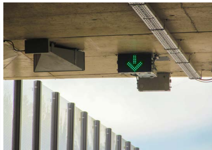
24 Dauerlichtzeichen zeigen an, welche Fahrspuren im Tunnel freigegeben und welche gesperrt sind.
